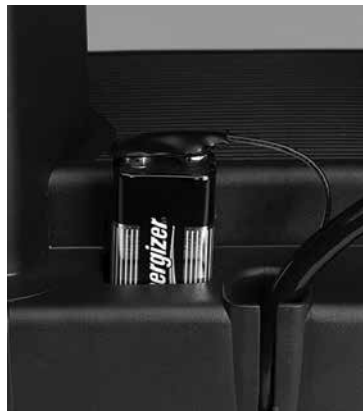
9-V-Blockbatterie für die Notabsenkung
