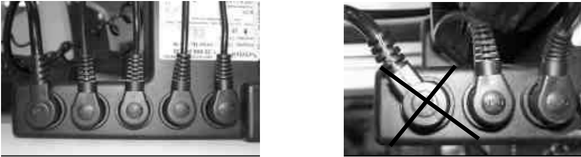
Fig. 11: Branchement correct des moteurs et de la commande manuelle NON CONFORME
