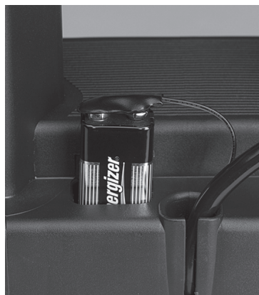
9-V-Blockbatterie für die Notabsenkung
